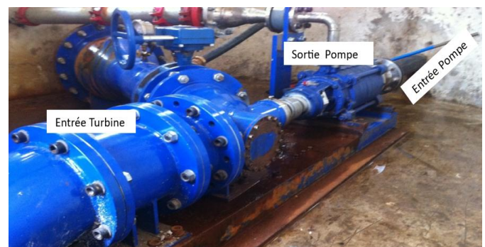
Figure 2. Station de pompage de Shamusenga Il y a lieu de retenir ce qui suit :
